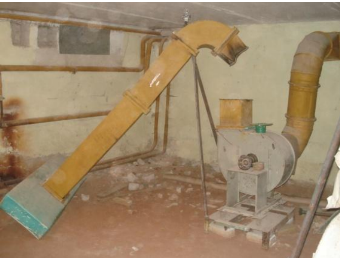
Вентилятор: вывод воздуха
